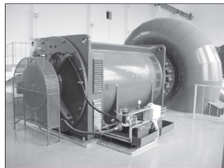
Generátor pro vodní elektrárnu Foto archiv autora
